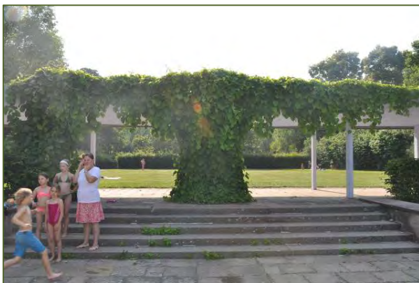
Abb. 191 Dachschäden an der Pergola, 2016
