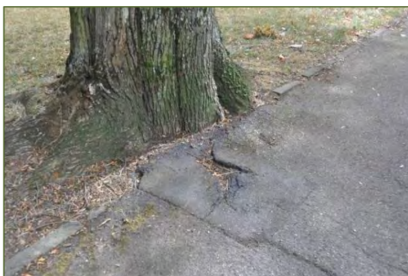
Abb. 39 Schadhafter Asphaltbelag am Wurzelhals, 2016
