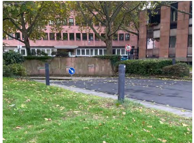
Abb. 92: Pollerleuchte Zufahrt Tiefgarage Deutschhausplatz
